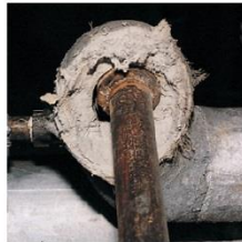
Calorifugeage sur un tuyau
