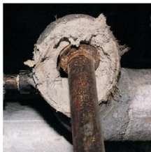
Calorifugeage sur un tuyau
