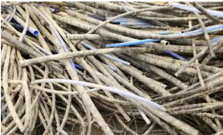
Tubulures sales ou pleines de terre/branches
